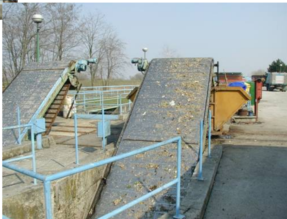
Mehaničko pročišćavanje – rešetke Otpadne vode Varaždina
