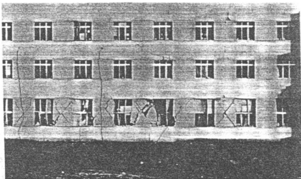
Slika 2.23 Karakteristična "X" pukotina kod zidane zgrade s monolitnim tavanicama, Budva, 1979
