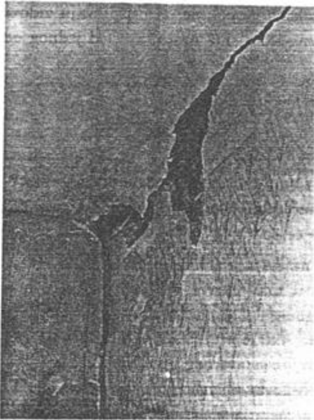
Slika 2.20 Pukotine na spoju zid - tavanica, Kozjansko, 1974
