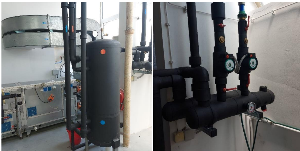
Slika 4. Klima komora sa akumulatorom toplote za ispitivanje rada sistema za klimatizaciju
