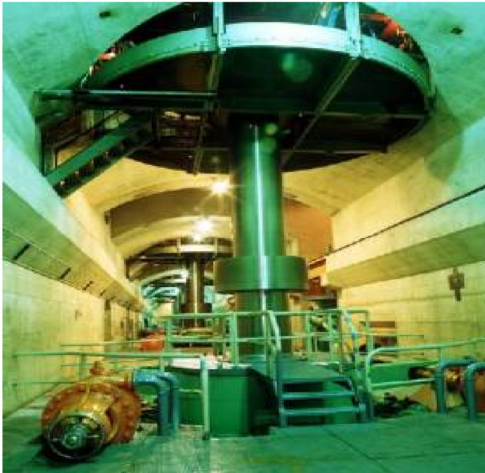
Vratilo koje povezuje generator i turbinu.
