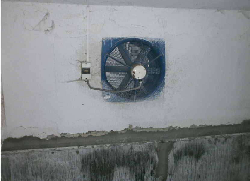
Slika 65. Vještačka ventilacija, sa ugrađenim ventilatorima u ventilacione otvore (Bojanić Rašović)
