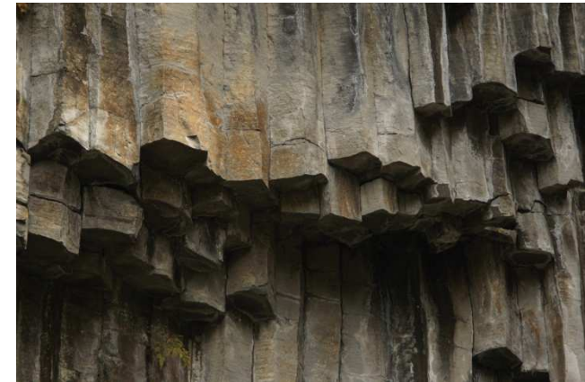
SLIKA 7.24 Pukotine lučenja (Foto: Kazue Asano/flickr)
