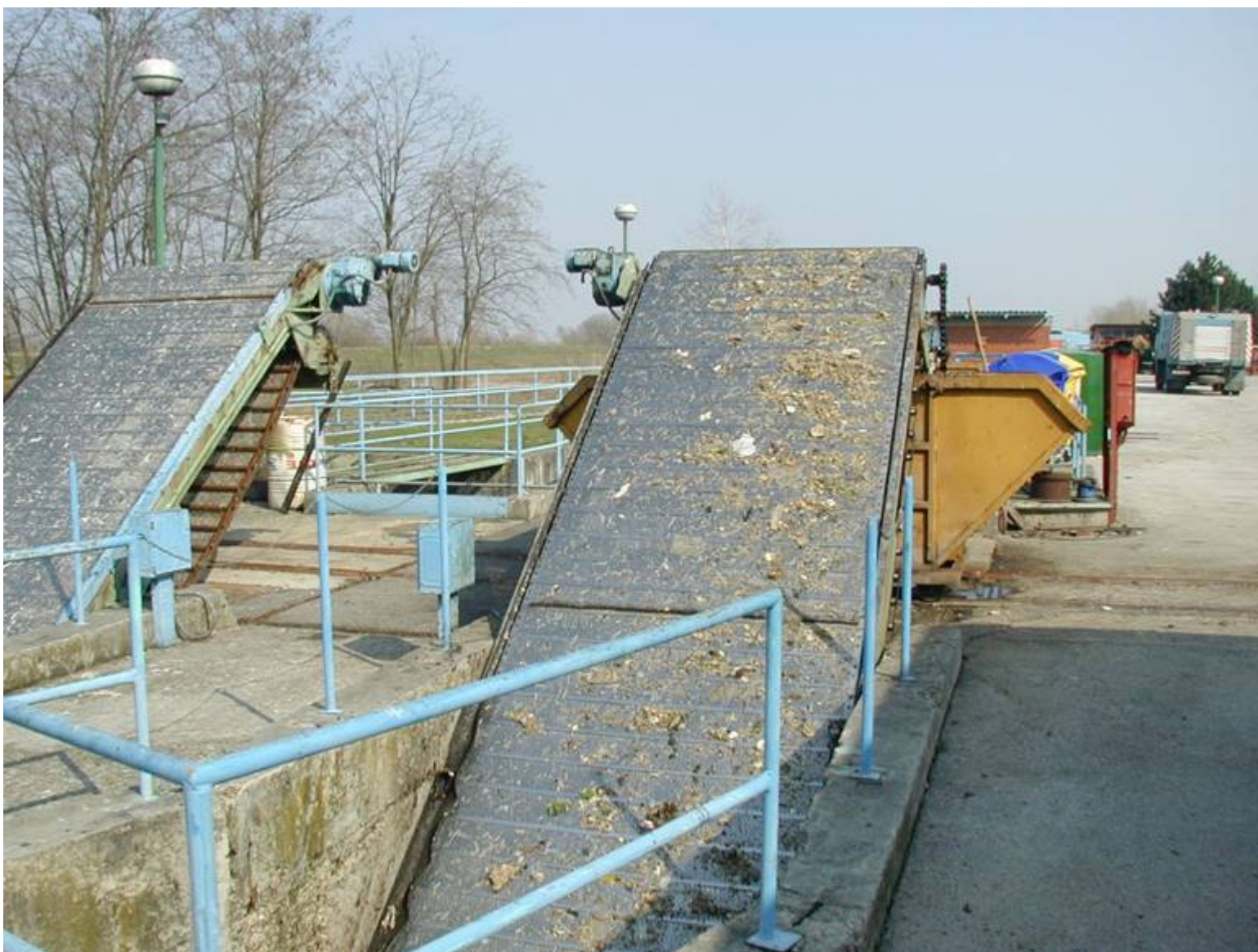
Dvije rešetke na ulazu u uređaj za pročišćavanje otpadnih voda grada Varaždina
