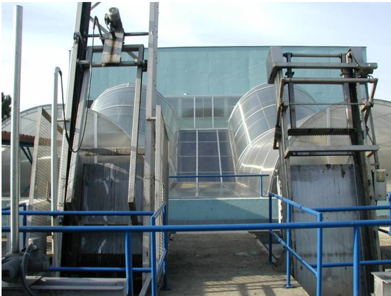
Dvije rešetke na ulazu u uređaj za pročišćavanje otpadnih voda na Delti
