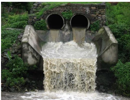
Slika 4. Ispuštanje otpadnih voda
