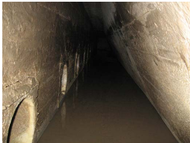
Slika Kanal ispod zvona pulzatora
