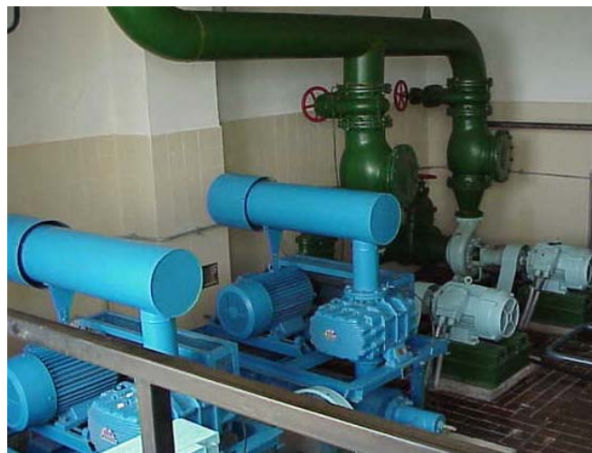
Slika Duvaljke za vazduh i pumpe za pranje filtera
